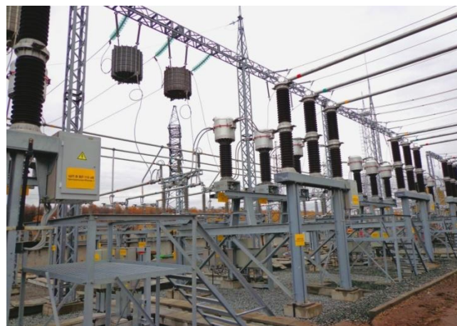
ПС Центральная (г. Казань)
