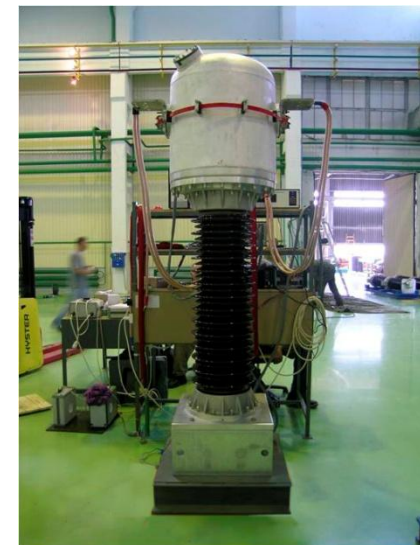
Трансформатор тока ТОГФ-110
