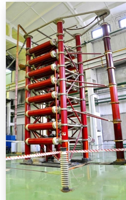
Высоковольтная испытательная установка УИВ - 500
